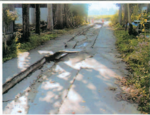
近くの陥没した道路
