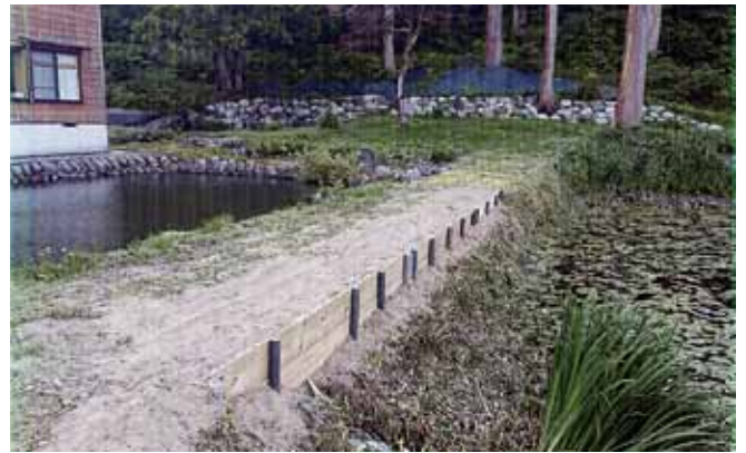
除雪作業で崩れた路肩工事
