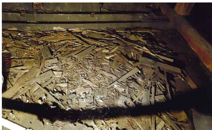
本堂の屋根裏のゴミ
